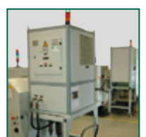
INSTALLATIONS DE REFROIDISSEMENT
